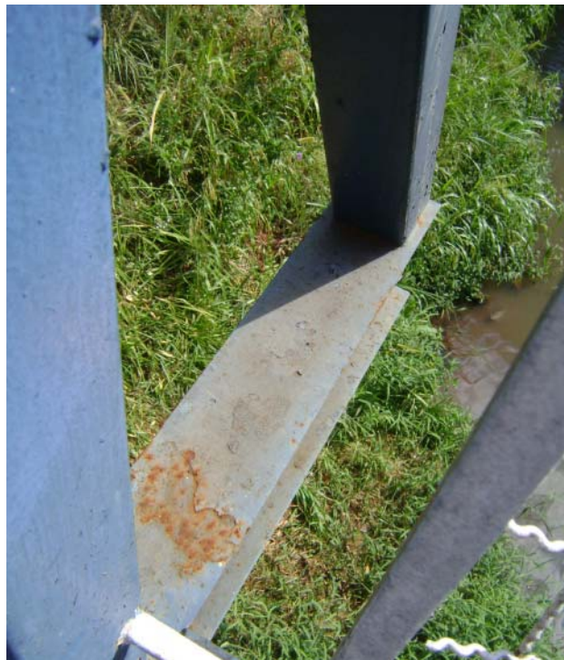
Esta ponte já está em processo de ferrugem
