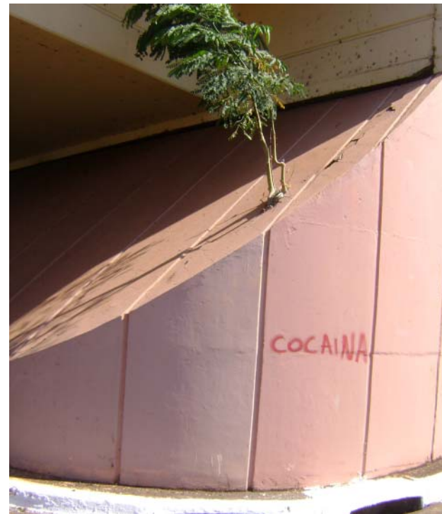
A água que fez crescer esta árvore pode retirar o cimento embaixo do viaduto Airton Senna
