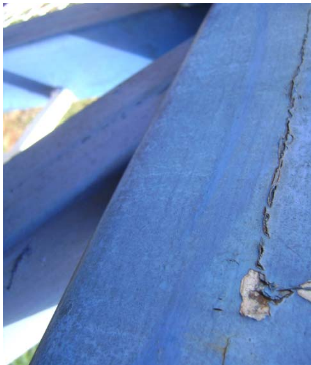
A água pode penetrar nesta rachadura e provocar ferrugem na ponte, e ocasionar sua queda
